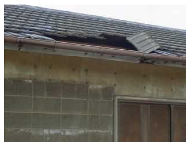
瓦が飛んだ体育倉庫
