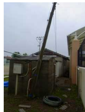
電柱も傾いて
