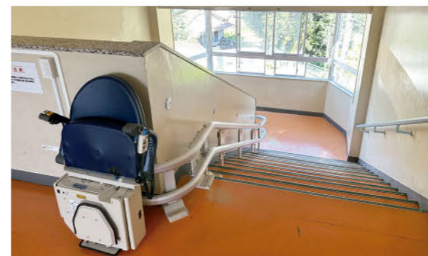
▲いすに座って階段を登り降りする「いす式階段昇降機」を設置
