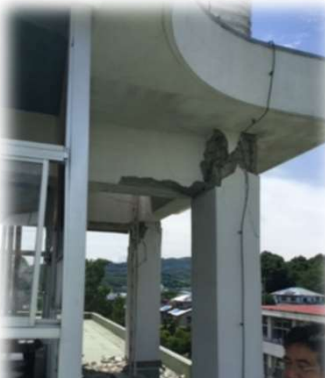
熊本地震で崩れた旧不知火小学校舎 (平成28年7月撮影)
