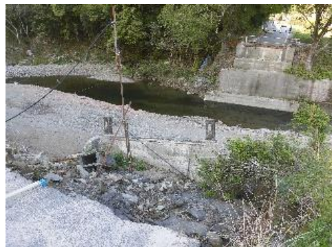
・令和2年7月の豪雨災害で橋が損壊し、通行できない。
