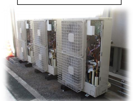
体育館空調の室外機
