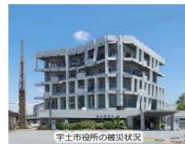
宇土市役所の被災状況
