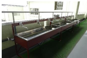
東棟への渡り廊下の手洗い場
